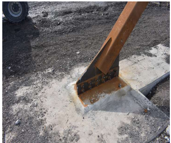
Portique de signalisation routière
